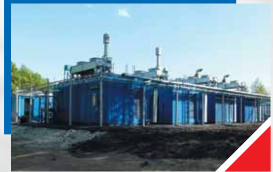
Энергокомплекс мощностью 2 МВт на попутном газе с СУОТ для Елабужского месторождения.
