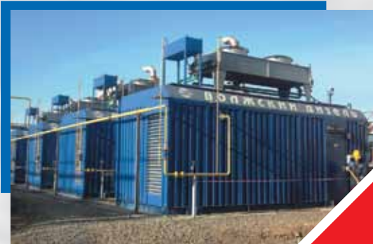
Энергокомплекс мощностью 3 МВт на природном газе с СУОТ для стекольного завода в Ростовской области.
