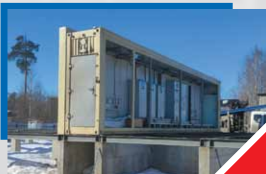
Архангельская обл-ть. Сборка высоковольтного блочно-модульного энергокомплекса на объекте Заказчика.
