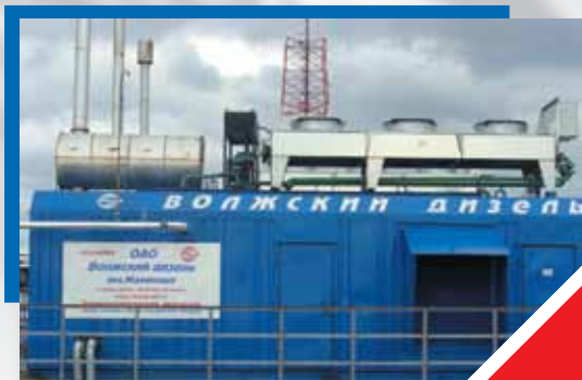
Томская область. Энергокомплекс для м/р «Казанское». ГДГ90 и ДГР520/1000 (2000 кВт).
