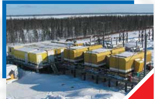
Высоковольтный дизельный энергокомплекс мощностью 3 МВт для жилого поселка.
