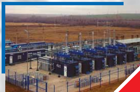
Газопоршневой энергокомплекс суммарной мощностью 4,6 МВт на попутном газе с СУОТ для месторождения Газпрома.
