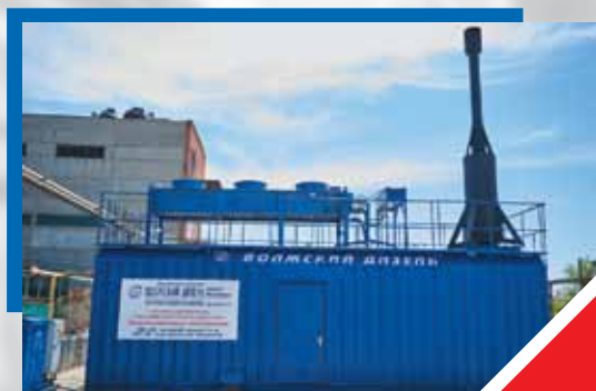
Тульская обл., резервное электроснабжение зернохранилища. ГЭ10У (0,4 кВ, 500 кВт).
