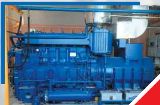
Электростанция для резервного энергоснабжения бумажной фабрики в Курской области. ГДГ 90 (500 кВт).
