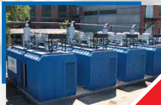
Балаково, Саратовская обл., площадка «Волгодизельмаш». ГДГ 90 (4x500 кВт).
